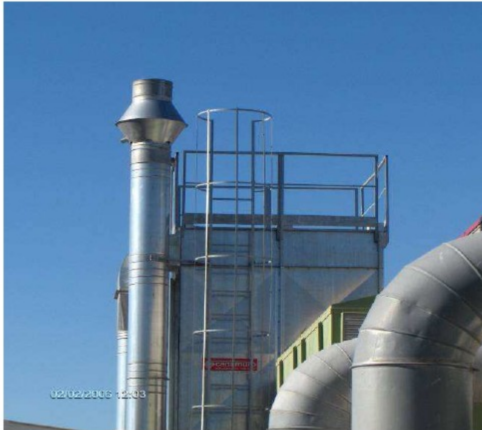
accesso con scala fissa ed uso come piattaforma della parte superiore del filtro a maniche opportunamente dotato di regolare parapetto
